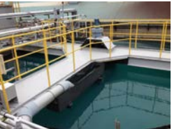
排水処理設備
