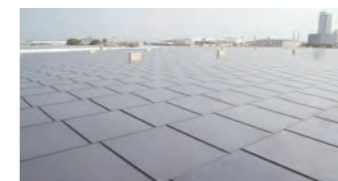
西島太陽光発電所
