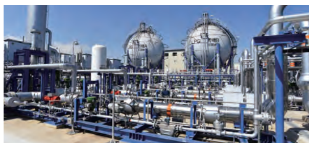
扇島都市ガス供給(株)の熱量調整設備
